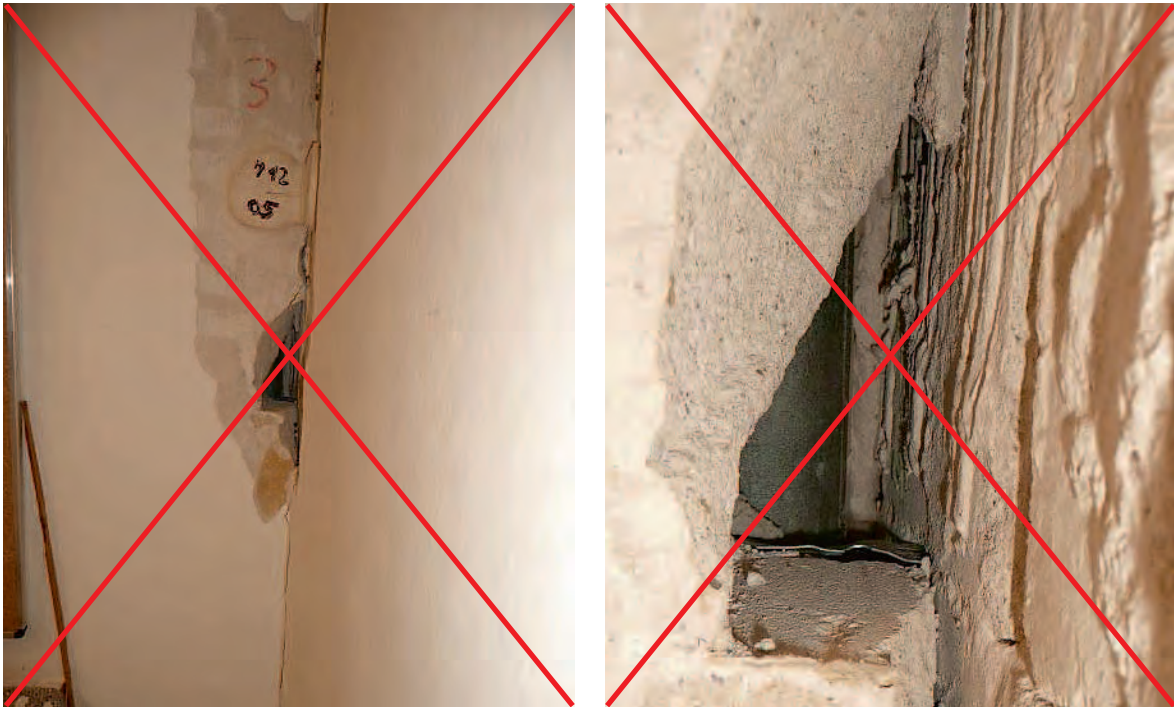
Bilder 7-6 und 7-7: Rissbildung am Wandanschluss, der Anker liegt unvermörtelt in der Lagerfuge
