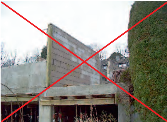
Bild 11-6: Durchfeuchtung von Mauerwerkswänden von oben
