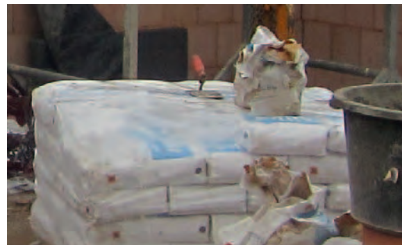
Bild 3.2-2: Mauermörtel (Sackware auf Palette) – Schutz vor Durchfeuchtung
