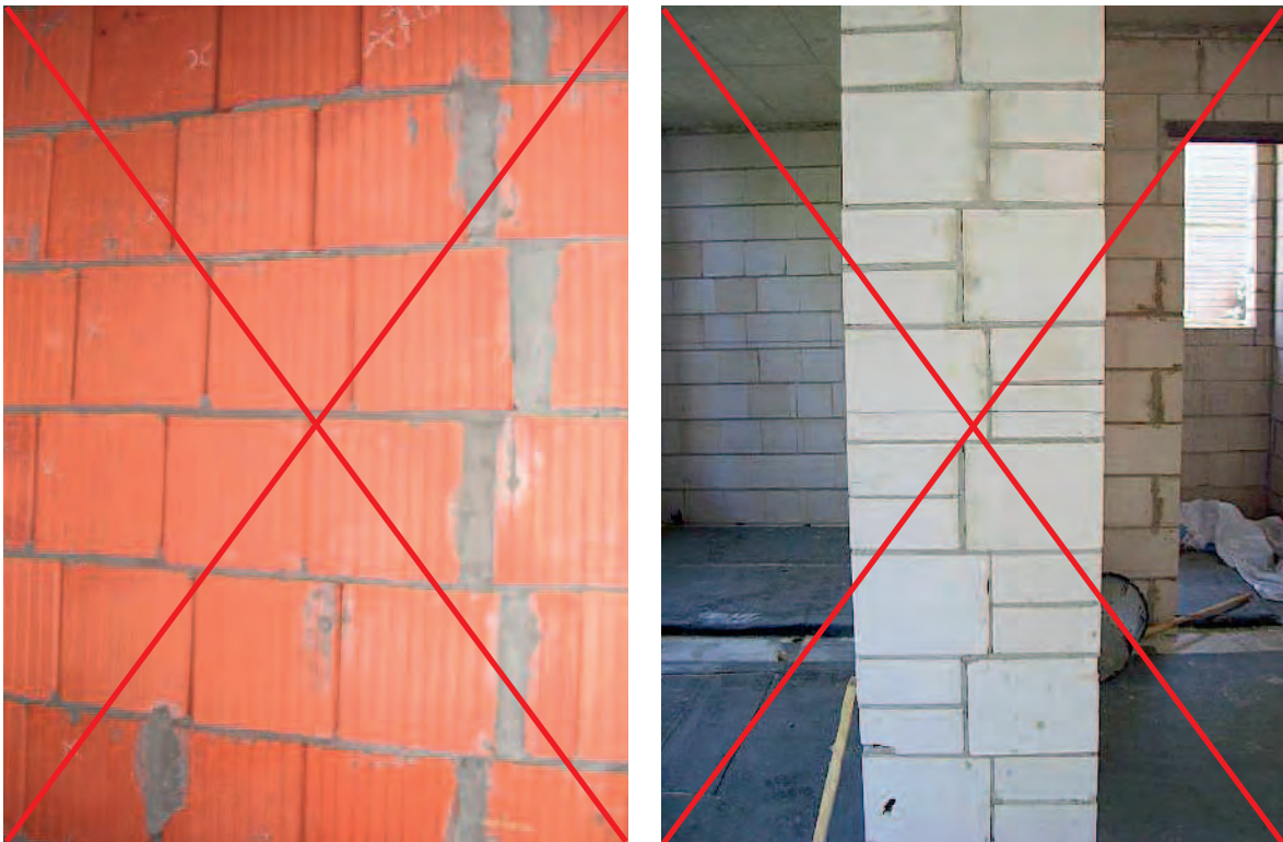
Bilder 4-4 und 4-5: Mauerwerk mit zu geringem Überbindemaß
