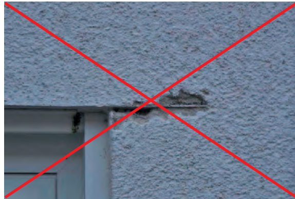
Bild 12.5-3: Randwinkel nicht eingekürzt, Bewehrung fehlt
