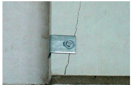
Bild 112. Zu geringer Randabstand eines Kunststoffdübels bei Montage einer Anschweißblase für die Befestigung einer Tür
