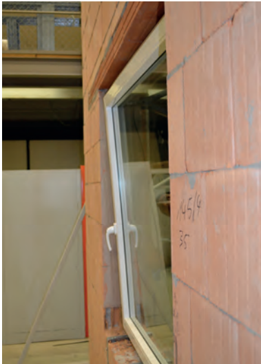
Bild 128. Auslenkung des Fensters bei statischer Prüflast von 3 kN ohne Befestigung oben und ohne seitliche Verklottung [110]
