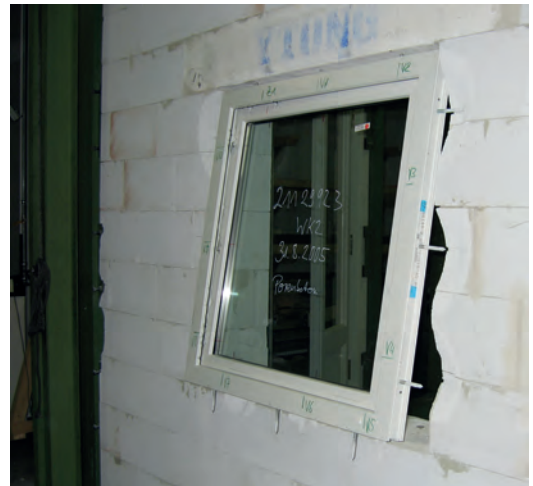
Bild 118. Aus dem Verankerungsgrund gerissenes Fensterelement bei zu geringem Randabstand in Porenbetonmauerwerk
