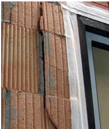
Bild 44. Steinausbruch beim Sicherheitsversuch mit ca. 2800 Pa und einem Randabstand von nur 5 cm [59]
