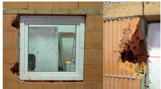
Bild 132. Freigelegte Verankerung nach manuellem Angriff in der Klasse RC 2
