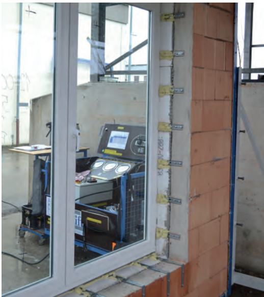
Bild 141. Montagesituation im Bereich der Brüstung und der Laibung mit Konsolen in einem Ziegelmauerwerk [111]
